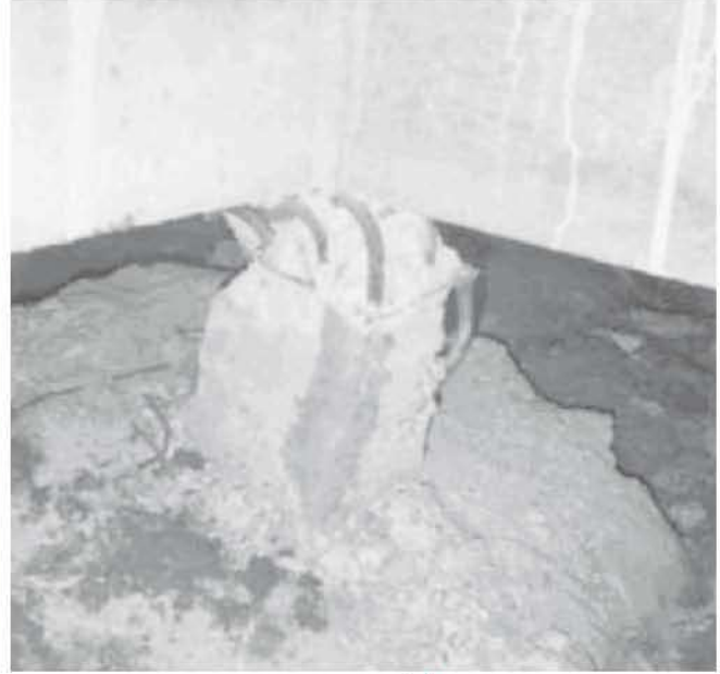
รูปภาพแสดงการดัดเหล็กที่ผิดมาตรฐาน เพื่อแก้ปัญหาเสาเอียงศูนย์จนโครงสร้างวิบัติ
