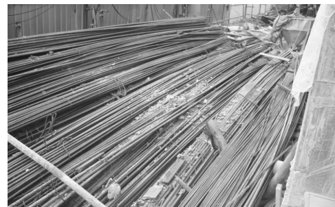
รูปภาพการจัดกองเหล็กเส้นแบบไม่เป็นระเบียบ วางบนพื้นดิน และไม่มีวัสดุปกคลุมเมื่อไม่ใช้งาน
